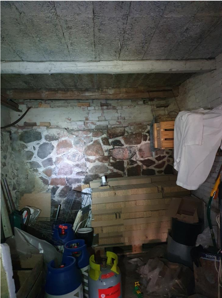
Figur 13: Opbevaringsrum/skur rum i enden af staldbygning, med flere sprækker og revner.
