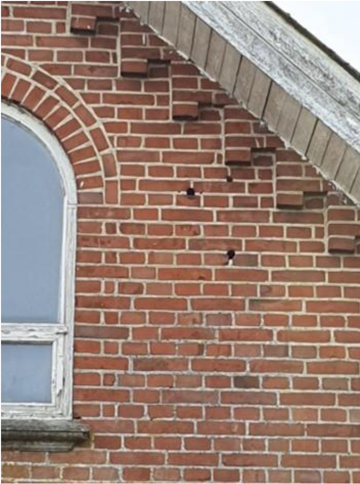
Figur 14 Huller i ydervæggen på stuehus
