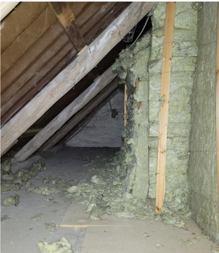
Figur 24 Nordvendt loftrum, isoleringsmåttens er sandsynligvis ødelagt af husmår.
