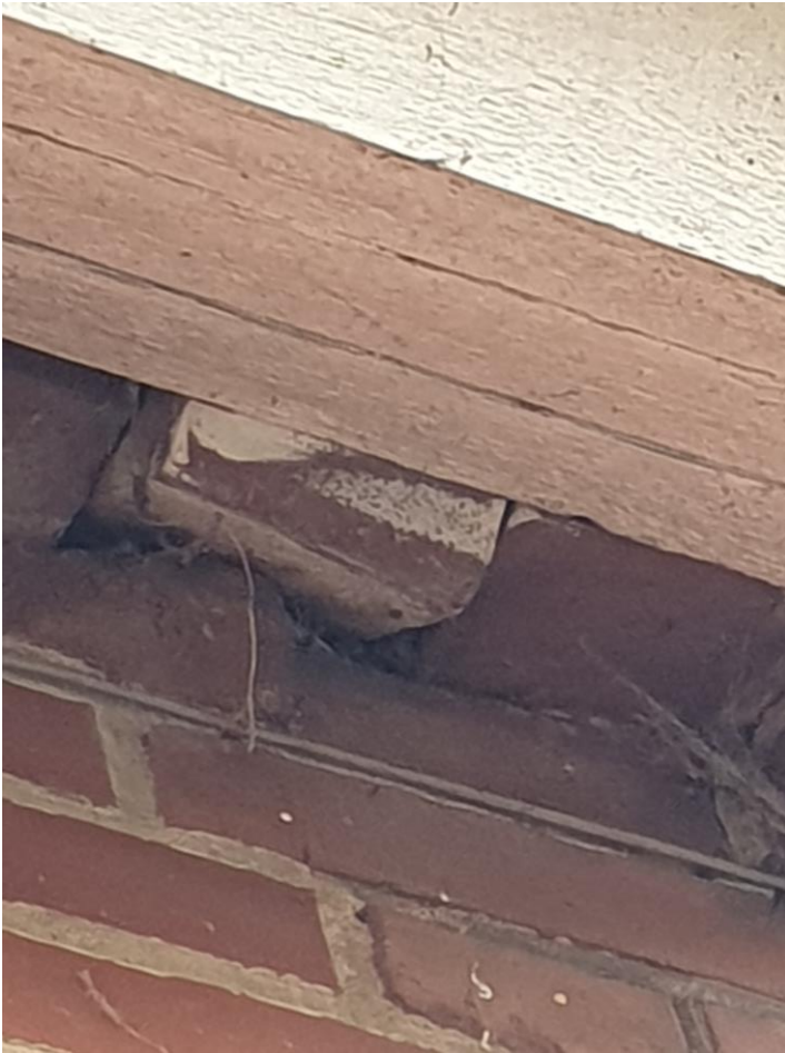
Figur 15 åbninger mellem murværk og tagudhæng på stuehus.
