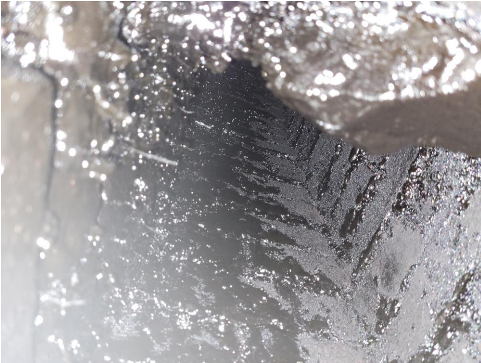
Figur 21 Skorsten under optænding.
