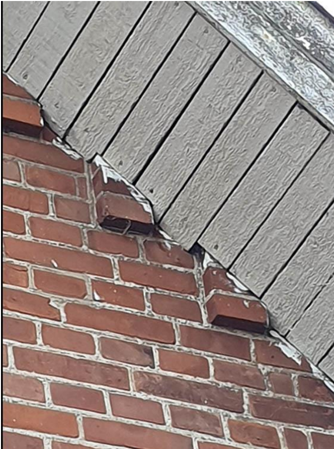
Figur 16 åbninger mellem murværk og tagudhæng på stuehus.
