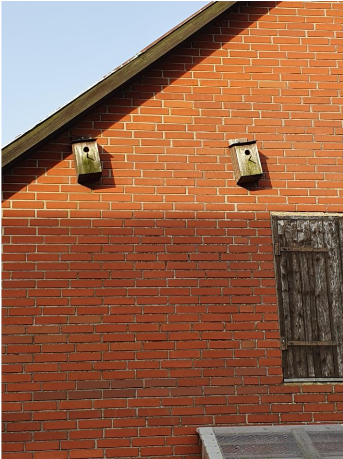
Figur 34: Fuglekasser på staldbygning.
