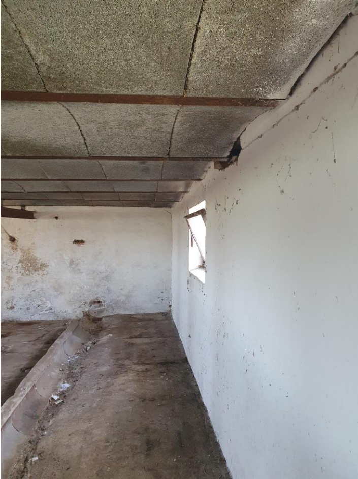
Figur 11: Staldbygning med åbent vindue og revner i væggen mod loftet.
